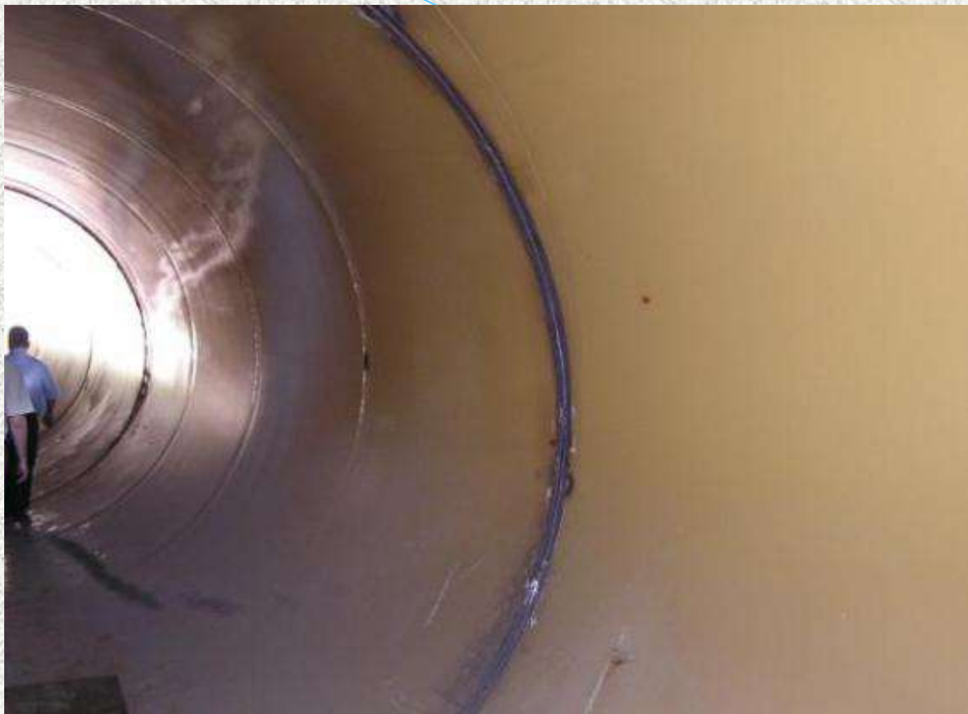
Άποψη του αγωγού προσαγωγής του ΜΥΗΕ Κιθαιρώνα
